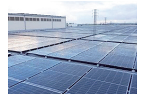
本社工場に設置した太陽光パネル
