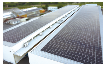
太陽光発電設備
